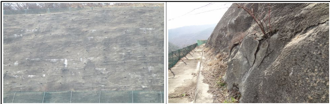
70.84K 3단 숏크리트 들뜸, 탈락
