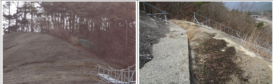
22.17K 4단 점검계단 연장요망
