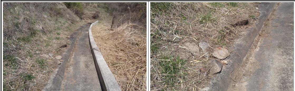
STA.38+570 1소단배수로 낙석퇴적
