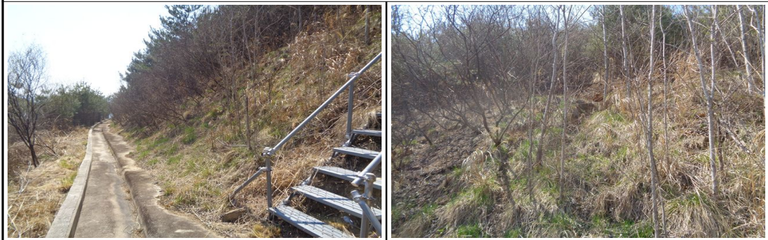
STA.38+540 5~7단 표층유실 및 세굴
