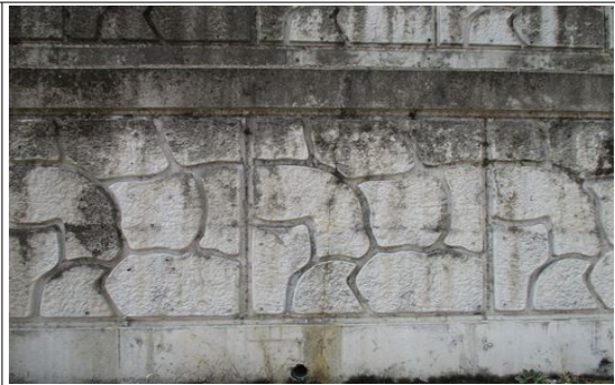
12.91K 계단식옹벽 균열 2.0
