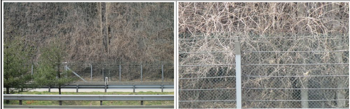
70.77K 1단 슛크리트 파손
