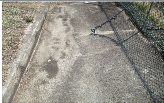
54.21K 1소단배수로 균열
