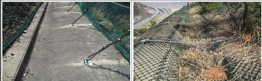
STA.0+050 1소단배수로 균열
