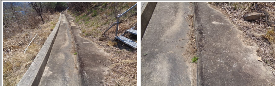
STA.38+550 1소단배수로 균열 (0.5)
