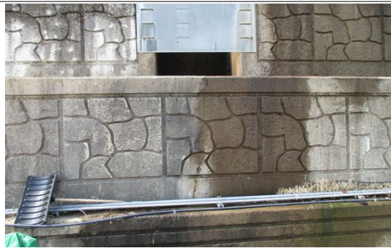
12.85K 계단식옹벽 균열 1.0
