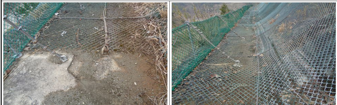
78.19K 1소단배수로 균열 1.0
