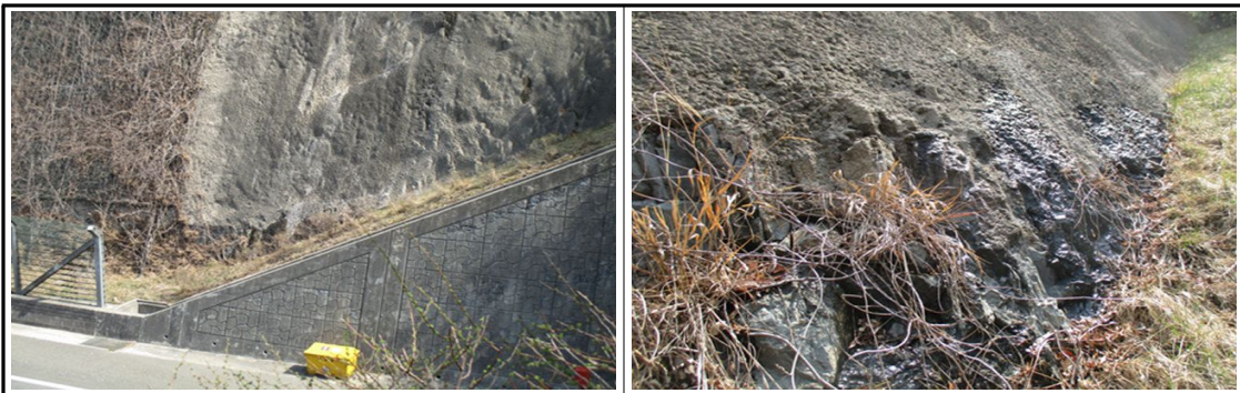
STA.0+040 1단 누수
