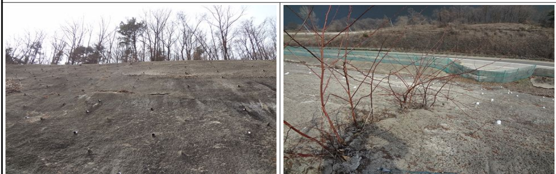
70.88K 4단 숏크리트 균열
