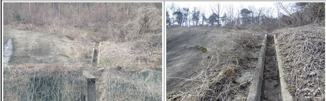
70.77K 2단 슛크리트 파손
