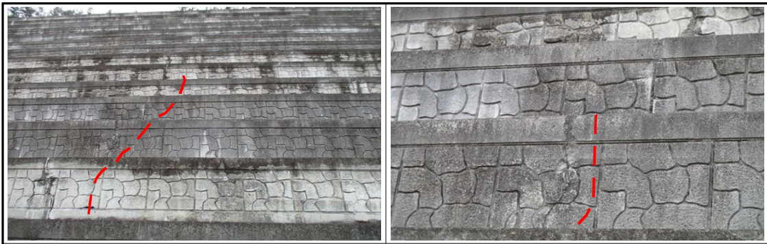
30.96K 1단 계단식옹벽 균열 및 파손
