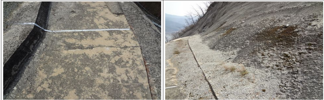
22.16K 3소단배수로 균열 0.5
