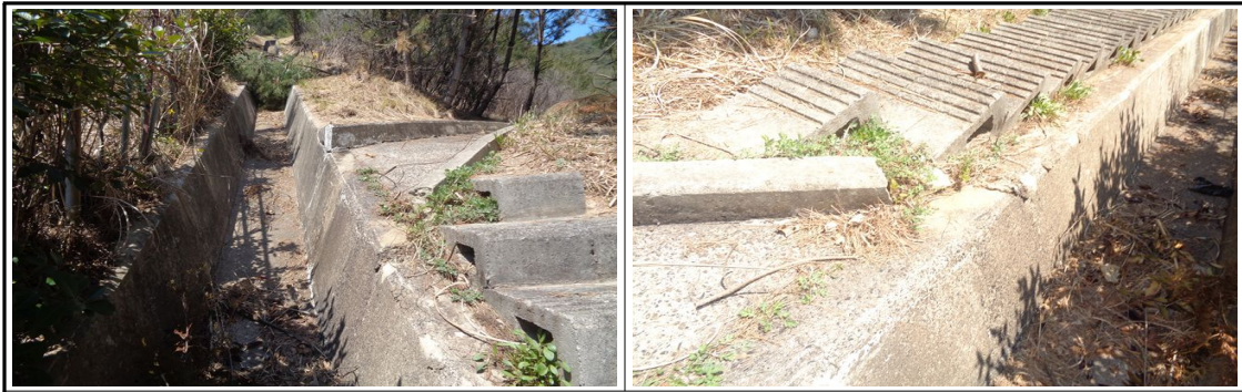
STA.38+450 1소단배수로 파손
