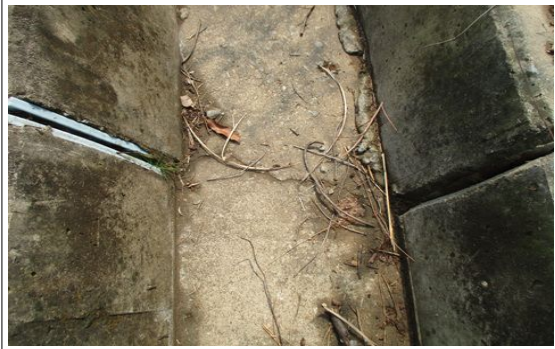
12.83K 산마루측구 균열 0.3
