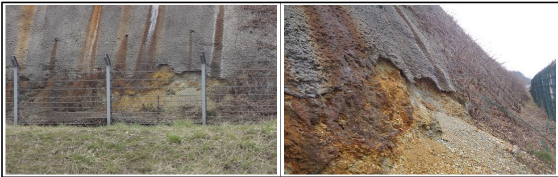
78.13K 1단 숏크리트 파손 및 하부퇴적
