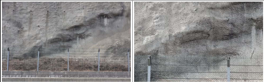
19.44K 1단 슛크리트 균열
